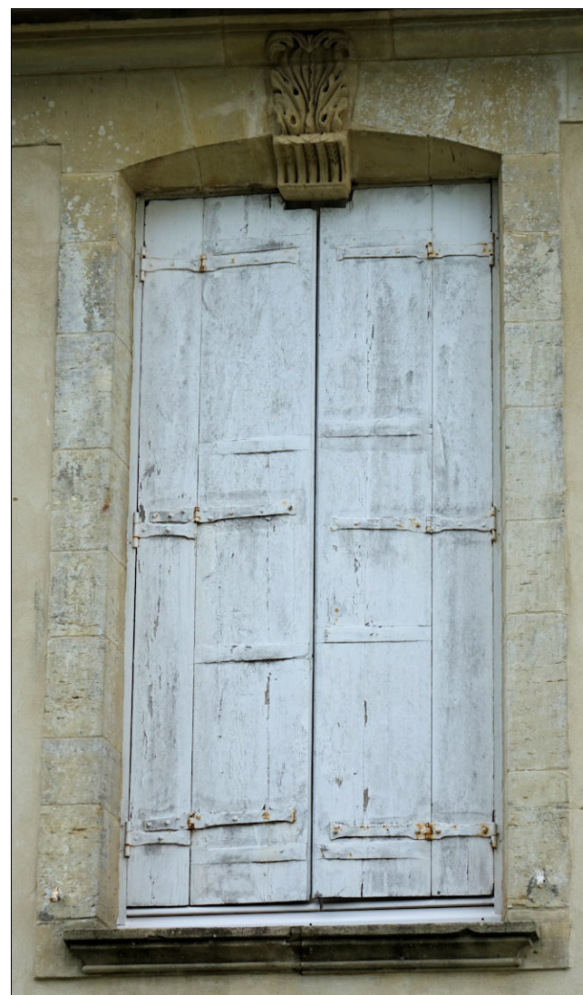
Fig. E.14. Contrevents brisés A.2.1 (avant restauration)
