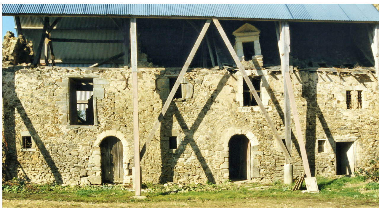
Fig. E.1. Le vieux logis avant sa restauration (état en 1996) Au premier étage, sous la lucarne, la croisée conservée.
