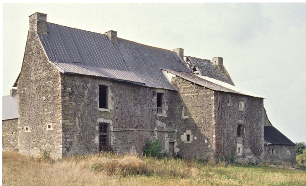
Fig. E.3. Façade postérieure et cage d'escalier, avant restauration (1996). Au rez-de-chaussée, près de la porte, la croisée murée B. A l'étage, immédiatement au-dessus, la croisée C.
